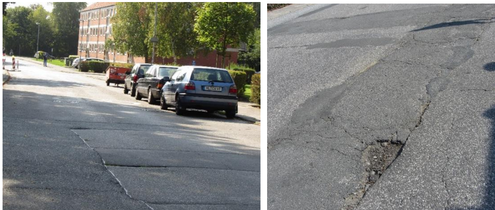
Abbildung 22: Zustand der Straßen im Quartier
