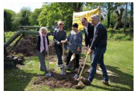
Spatenstich zum Start der Bauarbeiten am „Tag der Städtebauförderung“ mit Bürgermeister, Bause-natorin und Stadtteilbeirat, Mai 2019
